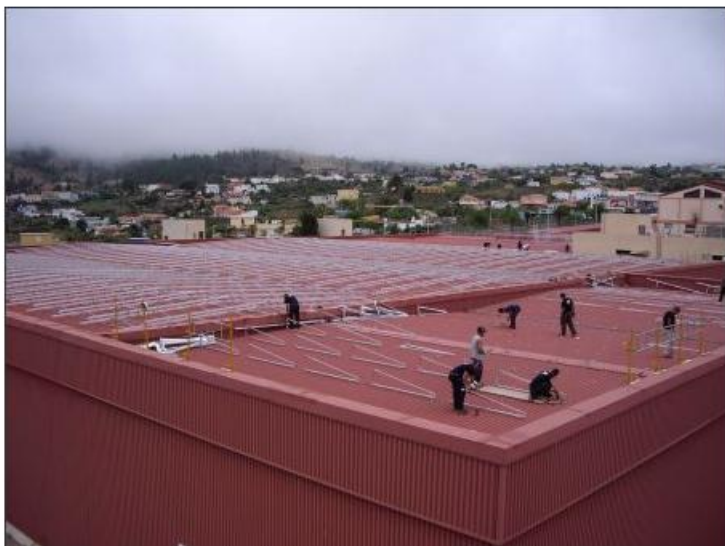
Energía fotovoltaica en el techo de la antigua JTI de El Paso. | publicada por: redaccion
